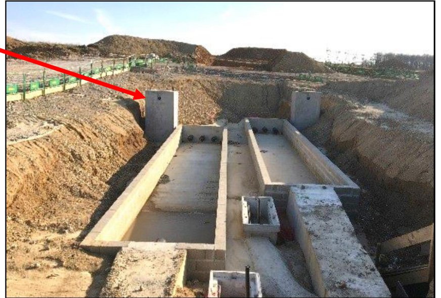
Chambres de jonction (non visitable)
