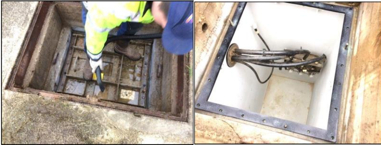
Puits de permutation (visitable)
